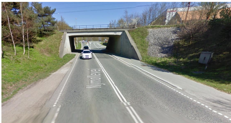
Figur 25 Foto af Nymøllevej umiddelbart før overføringen af S-togs banen set i retning mod øst (Sortemosevej).
